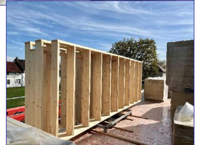
Die Holzrahmenelemente der Dämmwände stehen schon bereit, um an die Jahnhalle montiert zu werden.
