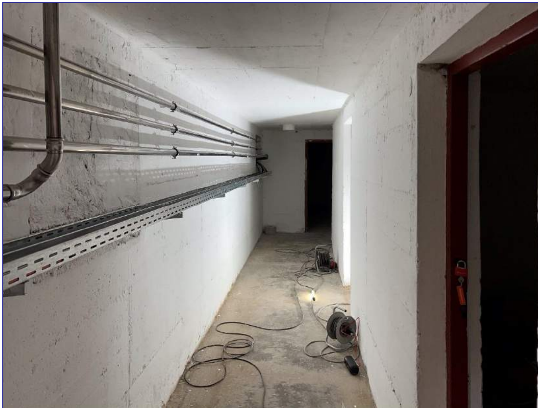
An der Kellerwand verlaufen die Heizungsrohre und Elektroleitungen in den Neubau. Sie stellen die technische Verbindung der beiden Gebäude dar.
