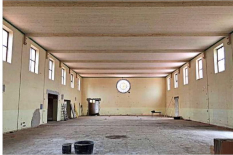
Unten Rohbau, oben neue Decke: So sah es vor einer Woche in der Jahnturnhalle aus. Als nächstes kommen die neuen Prallschutzwände und dann geht es an den Bodenaufbau. – Fotos: Brodschelm
