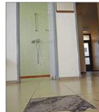
Einige PVC-Fliesen fehlen schon. Im Hintergrund sieht man die grün gekachelten Duschen.
