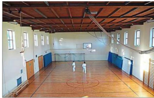
Die Jahnturnhalle von innen muss dringend renoviert werden, vor allem der nicht mehr zeitgemäße Holzboden. – Fotos: Archiv Brodschelm
