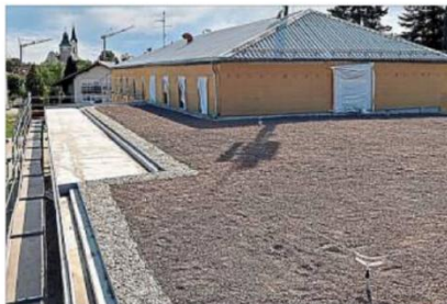
Das Substrat für die Begrünung am neuen Dach ist bereits ausgebracht, jetzt müssen nur noch die Moose, Kräuter und Gräser für die Insekten wachsen.
