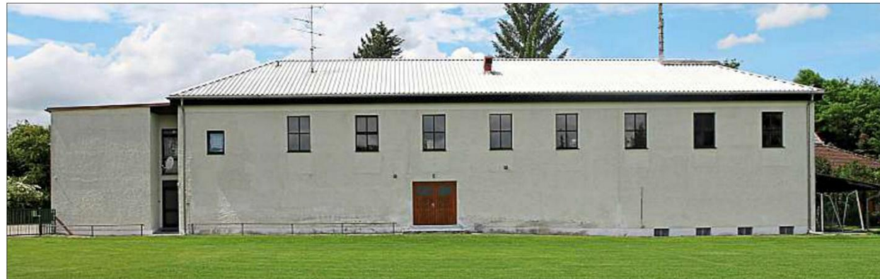
Eine moderne Sportstätte sieht anders aus. Die Jahnturnhalle des TSV Simbach müsste dringend saniert werden.
