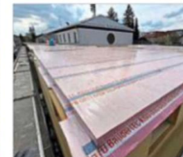
Bereits abgedichtet ist das Dach des Neubaus. Jetzt können Wolkenbrüche nichts mehr anrichten.
